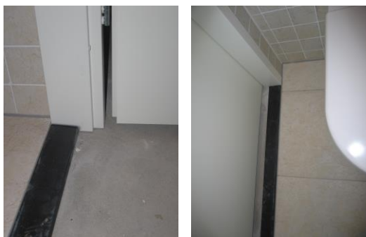
Afbeeldingen: foto's van een dorpel ter plaatse van de deuropening in toilet / badkamer.
